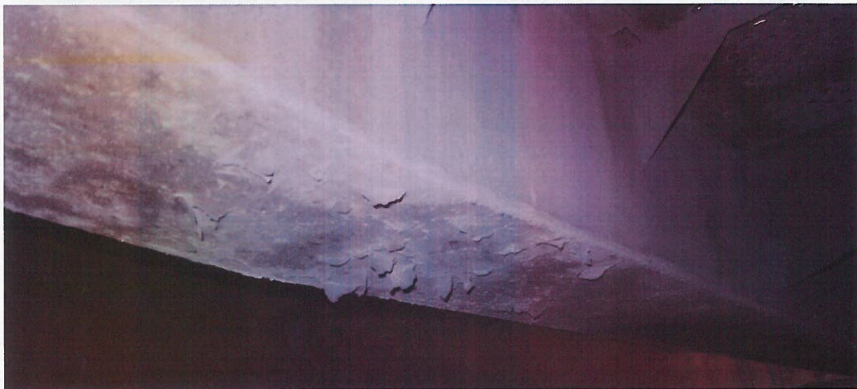
Fot. 7.1. Złuszczone zewnętrzna powłoka ochronna - pas dolny dźwigara z centralnie umieszczonym napędem jazdy mostem.
