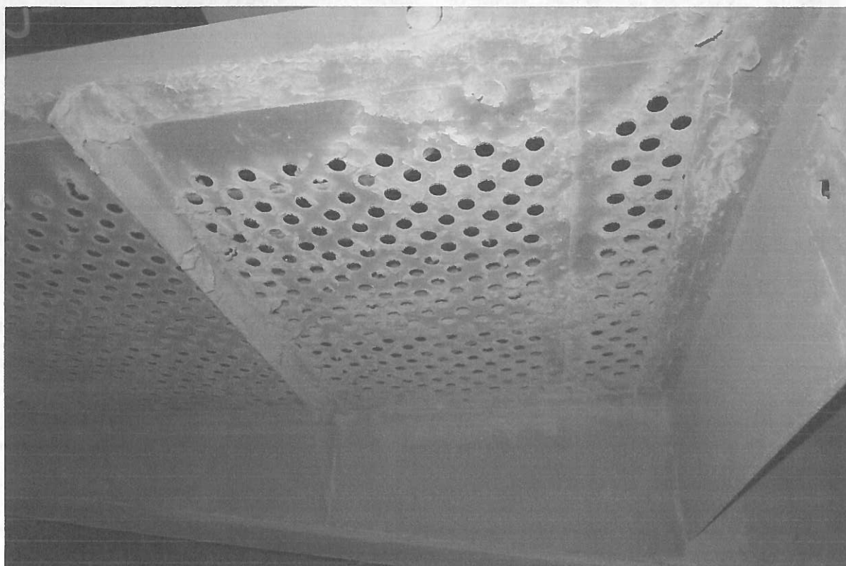
Fot. 7.4. Złuszczonej farby na elementach podestu komunikacyjnego.
