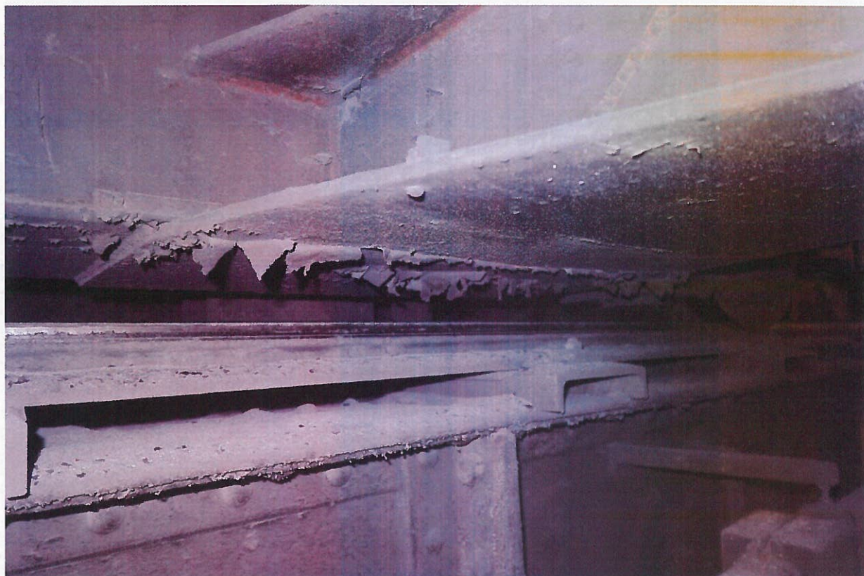
Fot. 7.3. Uszkodzona wierzchnia warstwa powłoki antykorozyjnej w wyniku działania lokalnie podwyższonej temperatury otoczenia > 45^{\circ}\text{C} – pas dolny łączy dźwigara z czołownią, strona lewa.
