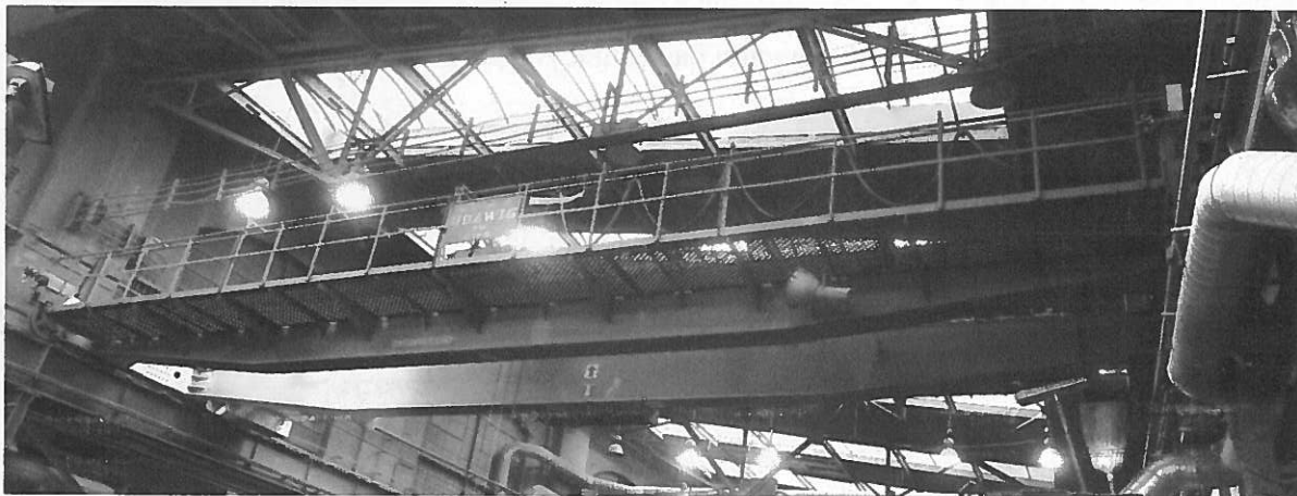
Fot. 2.1. Suwnica pomostowa lejnicza nr UDT3328000379 (10T).
