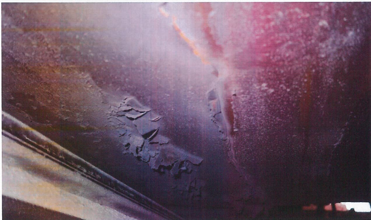
Fot. 7.2. Utrata ciągłości powłoki ochronnej w pasie dolnym czołownicy.
