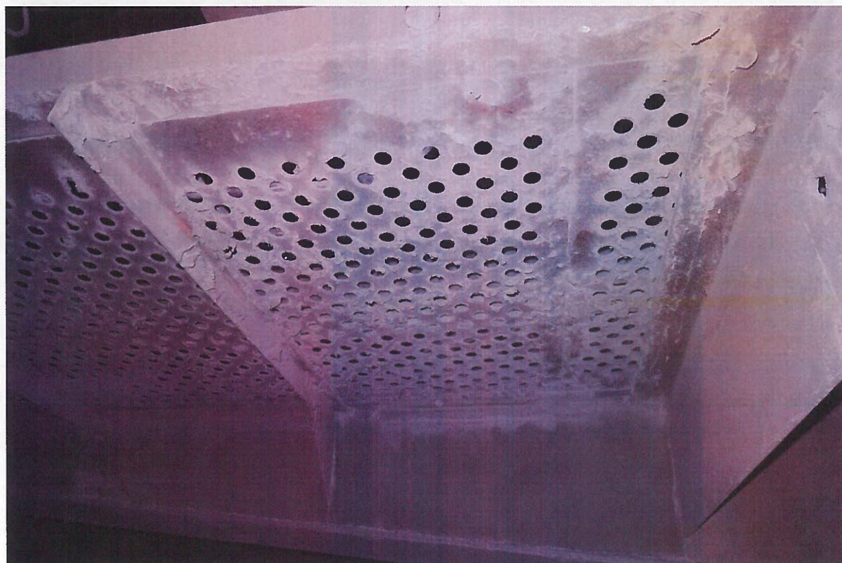
Fot. 7.4. Złuszczona farba na elementach podestu komunikacyjnego.
