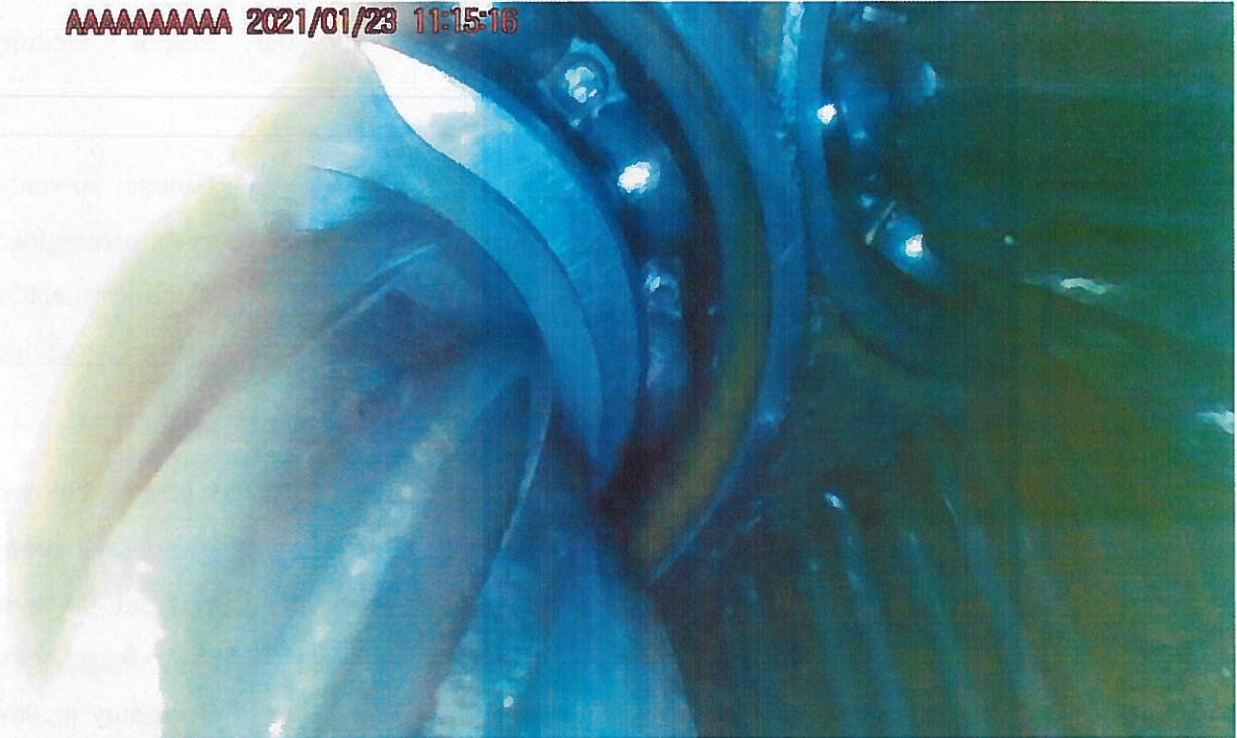
Fot. 8.6. Niski poziom oleju w motoreduktorach napędu jazdy wózka wciągarki.
