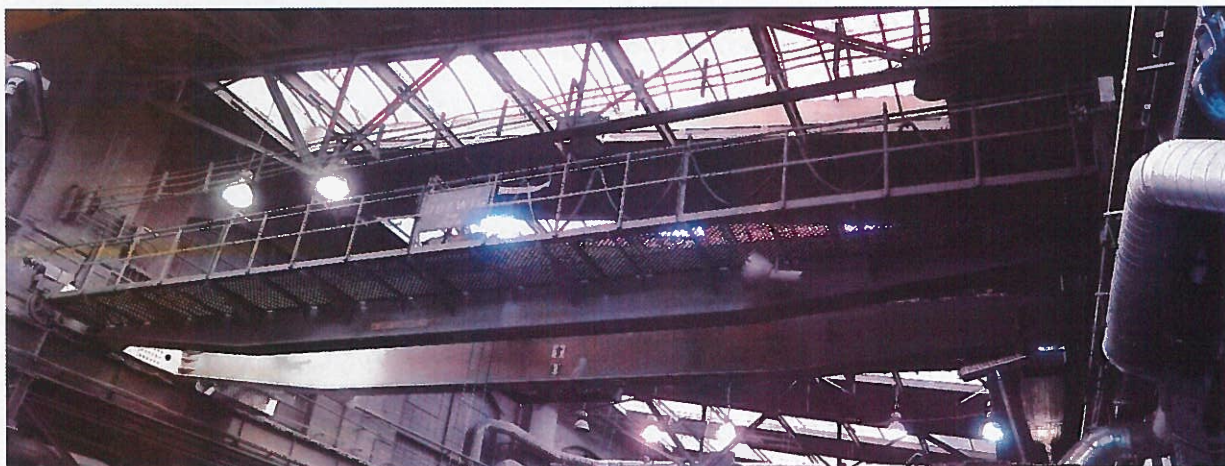
Fot. 2.1. Suwnica pomostowa lejnicza nr UDT3328000379 (10T).
