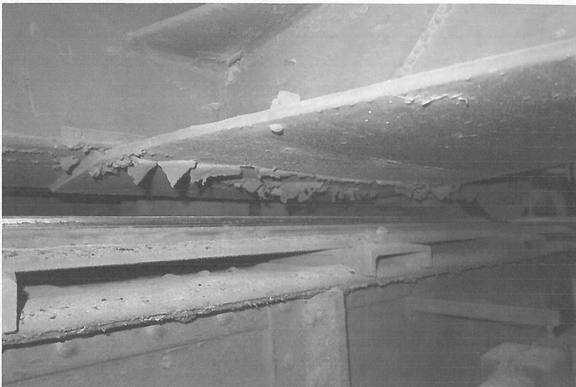
Fot. 7.3. Uszkodzona wierzchnia warstwa powłoki antykorozyjnej w wyniku działania lokalnie podwyższonej temperatury otoczenia > 45^{\circ}\text{C} – pas dolny łączy dźwigara z czołownicą, strona lewa.
